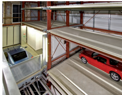
15 Mit gleichzeitigen X, Y Bewegungen (Vertikallift/ Shuttle) erreicht die belegte Parkpalette die Übergabekabine Ausfahrt. Sehr gut zu sehen ist auch die rückwärtige Absicherung am Shuttle, um den Zugang zum Arbeitsbereich zu verhindern.
