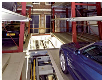
11 Nachdem der Vertikallift die angewählte Lagerebene erreicht hat, zieht das Shuttle die Parkpalette aus dem Lagerfach.
