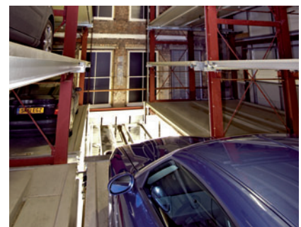
12 Ein Blick von innen zur Gebäudefassade: Die Stahlkonstruktion vom Parksafe sichert und stabilisiert die denkmalgeschützte Fassade.
